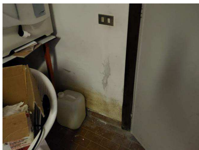
Tracce di infiltrazioni
